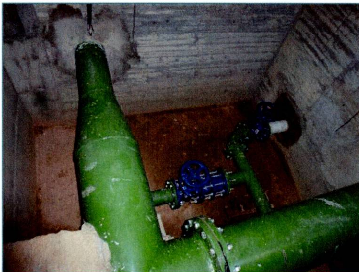
Figura 6 – Interior da câmara de válvulas (nó 2.12')
